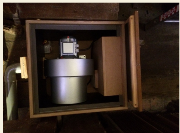
Le nouveau ventilateur installé
