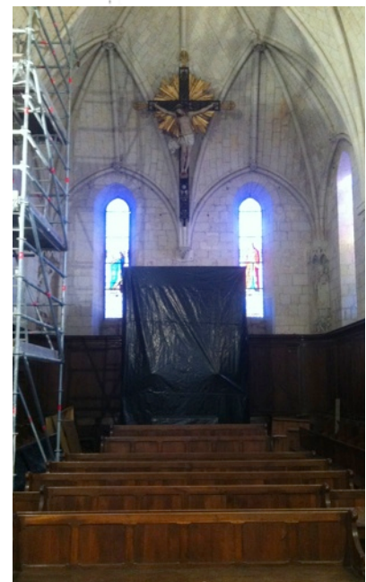
... et celui installé à l'intérieur
